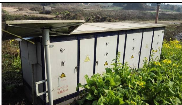
雅化工业园调压柜
