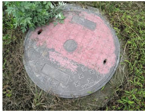
永兴大道南段阀门井
